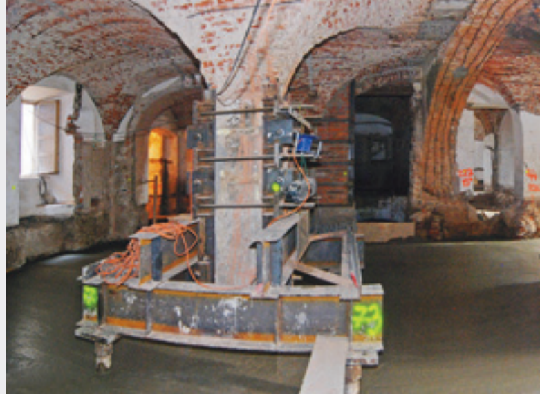
▲ Sloupy SL1 a SL2 v původní barokní místnosti byly sepnuty a vyvěšeny na mikropilotové bárky a uvnitř posílány ocelovou trubkou
